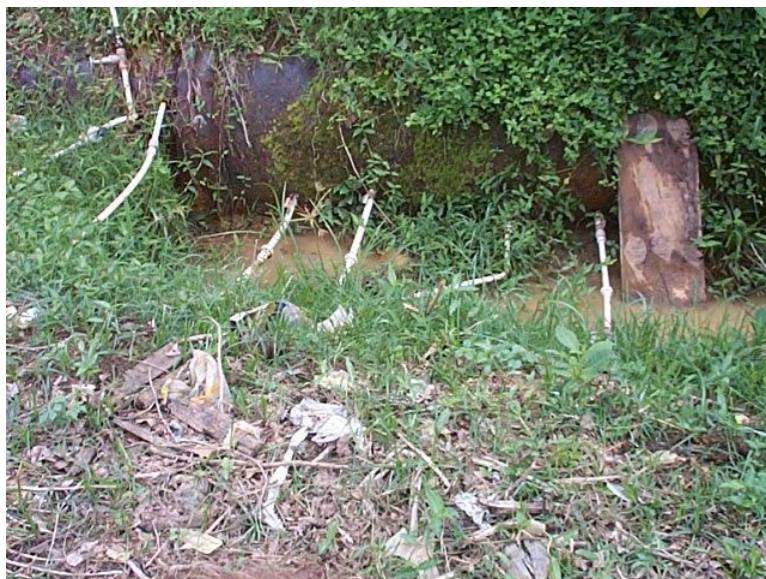
FLAGRANTE DE LIGAÇÕES CLANDESTINAS EM ADUTORA
