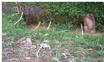
Flagrante de ligações clandestinas em adutora
