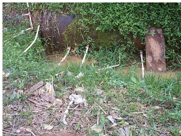
FLAGRANTE DE LIGAÇÕES CLANDESTINAS EM ADUTORA
