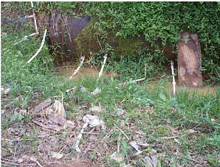
FLAGRANTE DE LIGAÇÕES CLANDESTINAS EM ADUTORA
