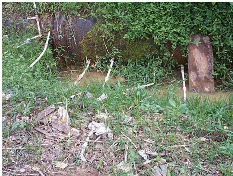
FLAGRANTE DE LIGAÇÕES CLANDESTINAS EM ADUTORA
