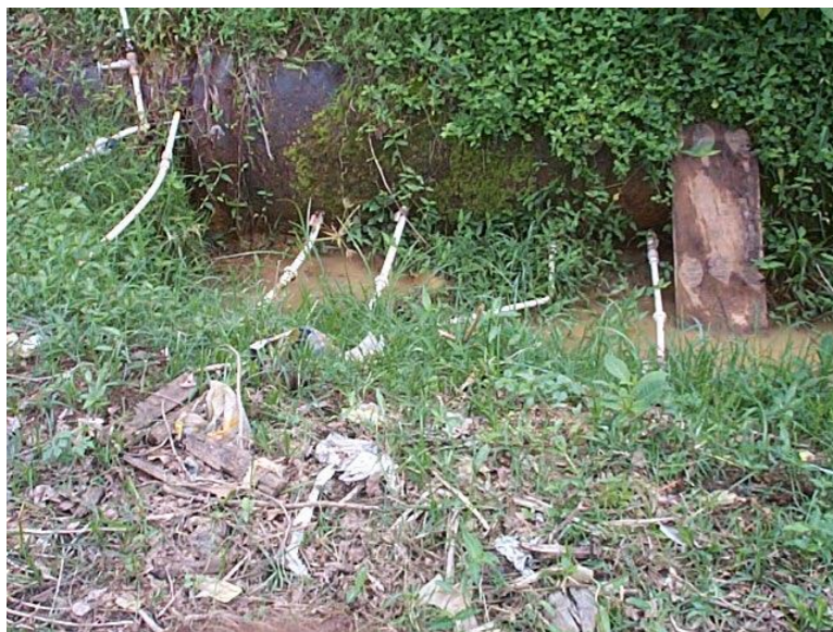
FLAGRANTE DE LIGAÇÕES CLANDESTINAS EM ADUTORA
