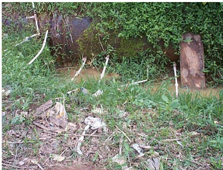
FLAGRANTE DE LIGAÇÕES CLANDESTINAS EM ADUTORA
