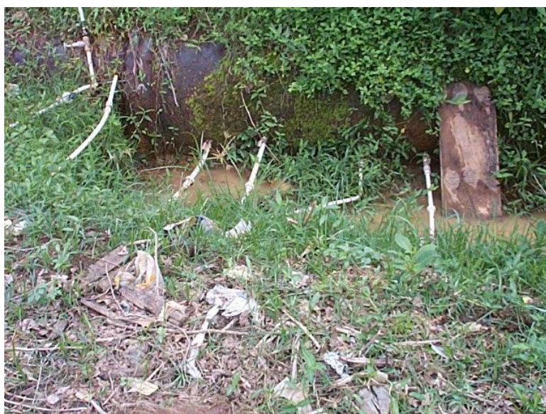
FLAGRANTE DE LIGAÇÕES CLANDESTINAS EM ADUTORA
