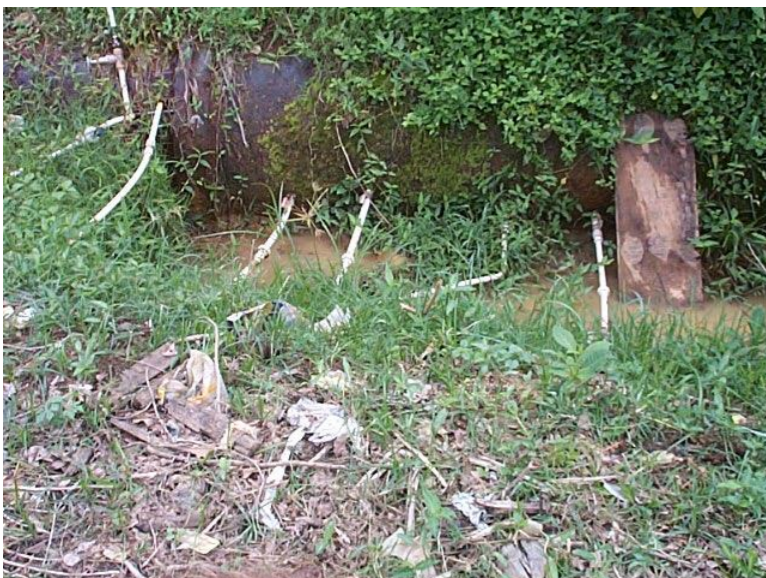
FLAGRANTE DE LIGAÇÕES CLANDESTINAS EM ADUTORA
