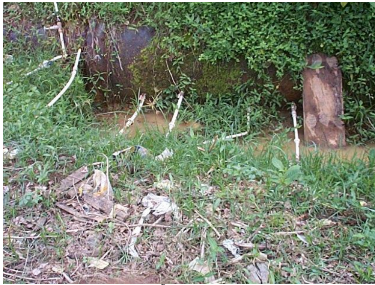
FLAGRANTE DE LIGAÇÕES CLANDESTINAS EM ADUTORA
