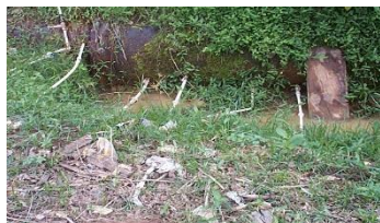
Flagrante de ligações clandestinas em adutora
