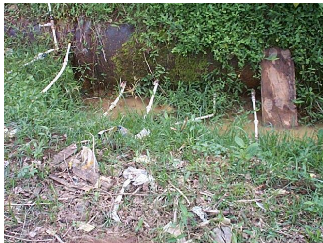
FLAGRANTE DE LIGAÇÕES CLANDESTINAS EM ADUTORA
