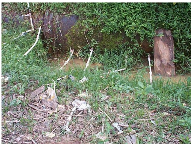
FLAGRANTE DE LIGAÇÕES CLANDESTINAS EM ADUTORA
