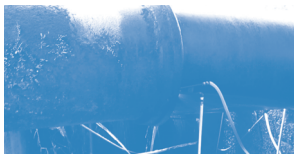
FLAGRANTE DE LIGAÇÕES CLANDESTINAS EM ADUTORA
