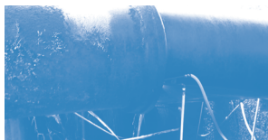
FLAGRANTE DE LIGAÇÕES CLANDESTINAS EM ADUTORA
