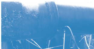
FLAGRANTE DE LIGAÇÕES CLANDESTINAS EM ADUTORA
