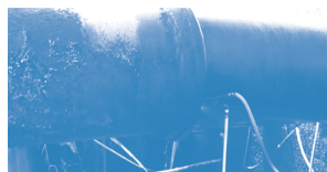
Flagrante de ligações clandestinas em adutora
