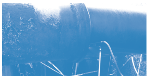
FLAGRANTE DE LIGAÇÕES CLANDESTINAS EM ADUTORA
