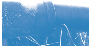
FLAGRANTE DE LIGAÇÕES CLANDESTINAS EM ADUTORA
